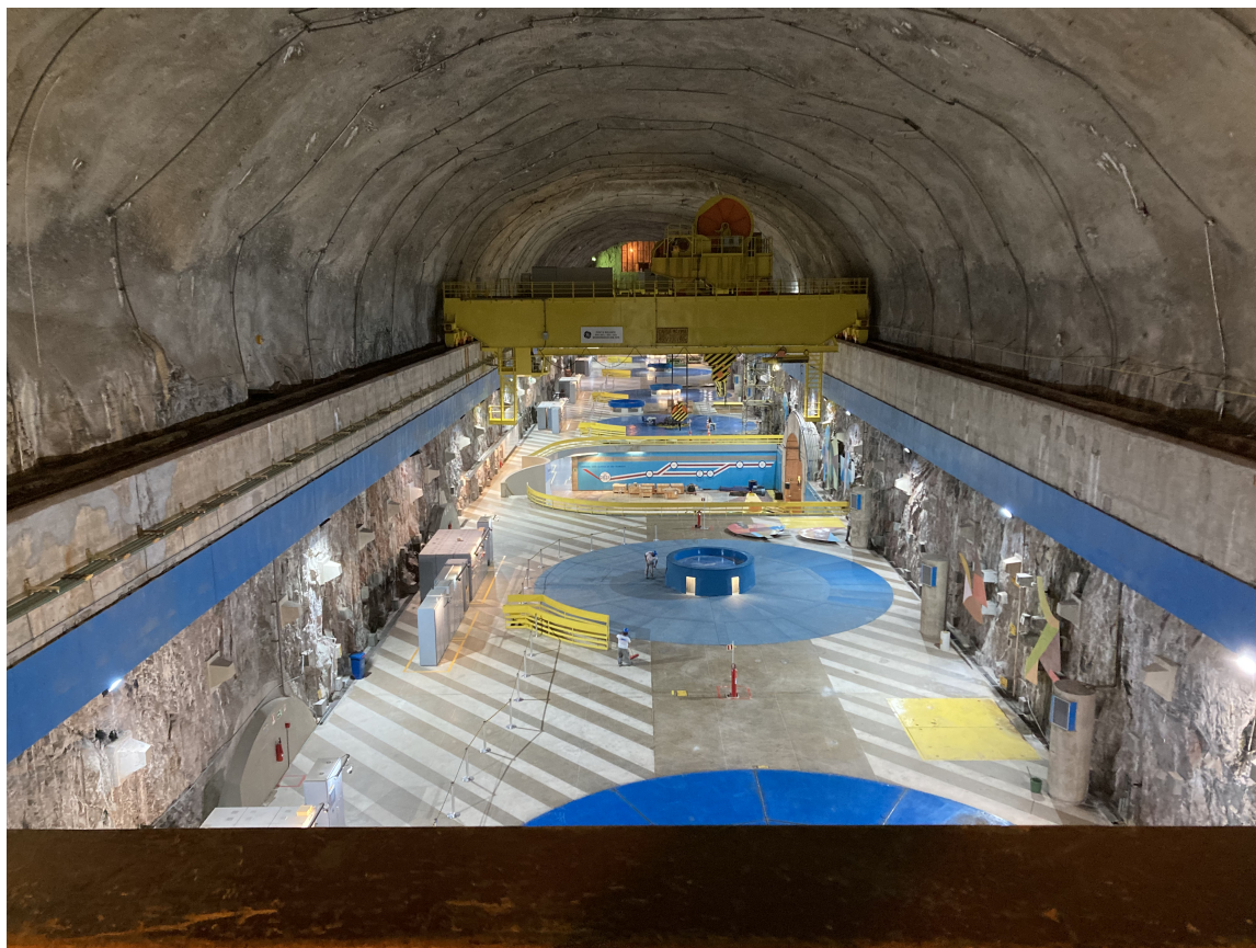
Figura 30 – Casa de força da usina, vista do mezanino.
