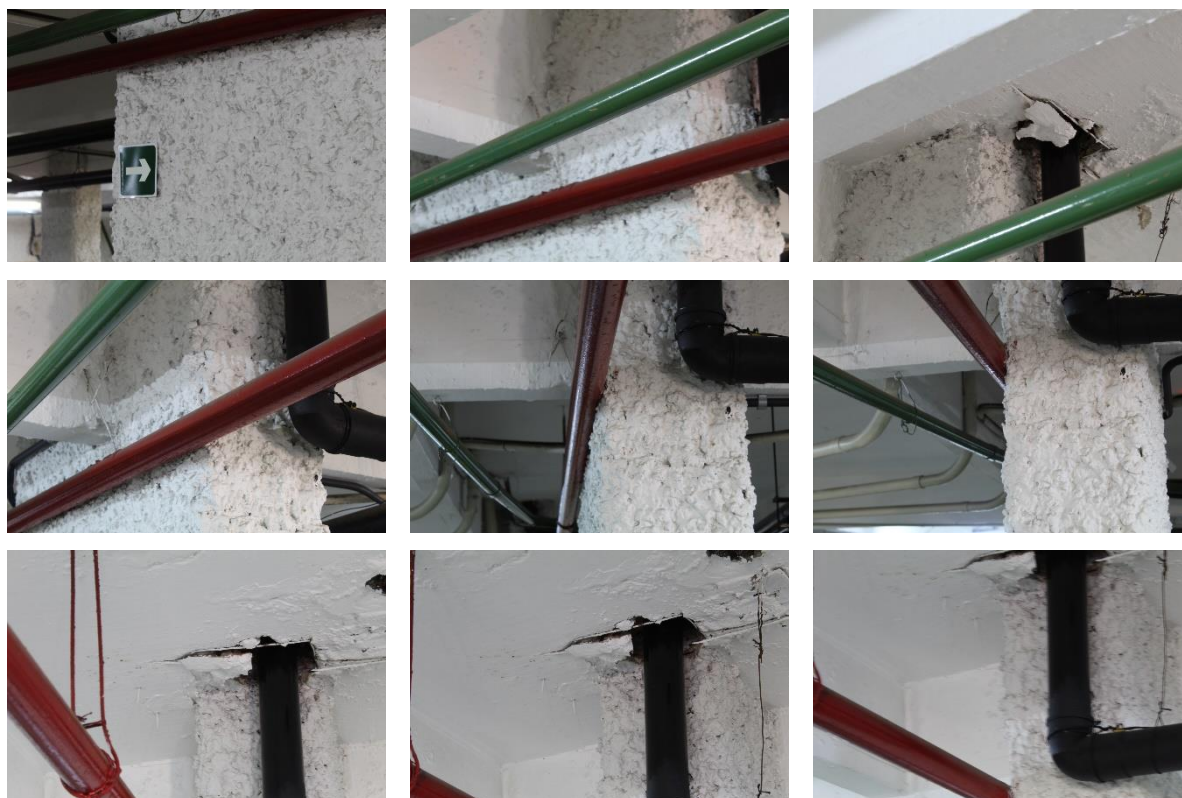
Figura 47 – Fotogrametria terrestre – Canos expostos em prédio em São Paulo - Amostra de fotos capturadas em campo.
