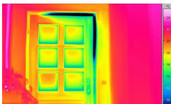
Figura 23 – Problemas de isolamento térmico na região da porta, detectados com câmera térmica
