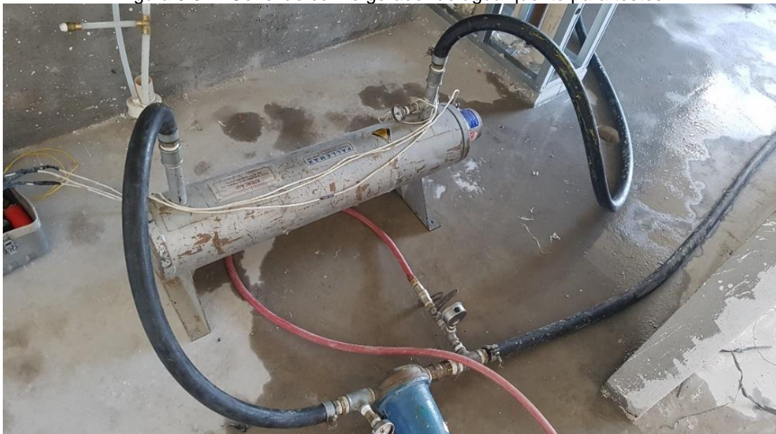
Figura 5.31 - Conexão com o gerador de água quente para testes
