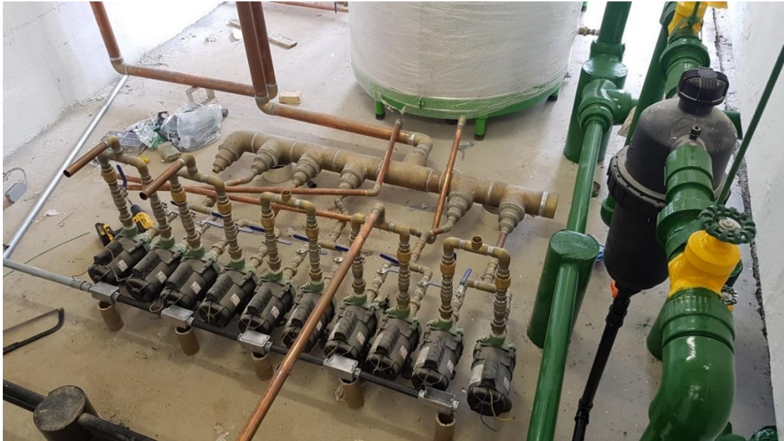
Figura 5.6 - Tubulações aparentes instaladas acima do piso
