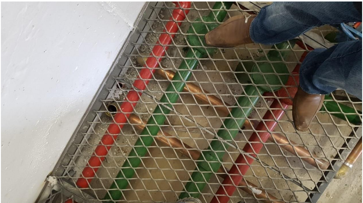
Figura 5.5 - Tubulação instalada sob piso elevado
