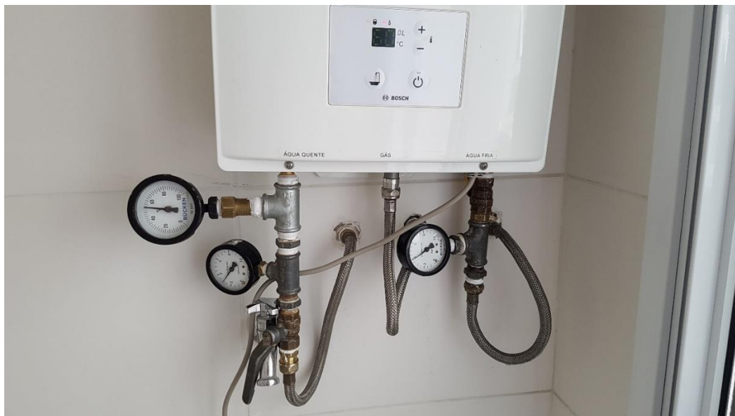
Figura 5.48 - Manômetros instalados na saída do aquecedor
