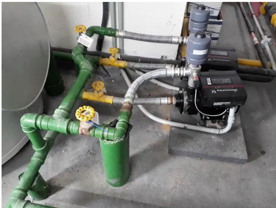
Figura 5.59 - Bomba conectada ao sistema por ligações flexíveis
