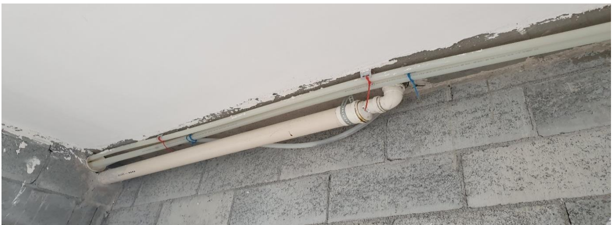
Figura 5.3 - Ramais suspensos de água quente e fria com tubulação flexível
