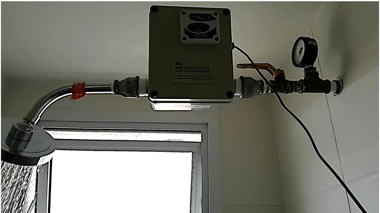
Figura 5.47 - Aparelhagem instalada em campo
