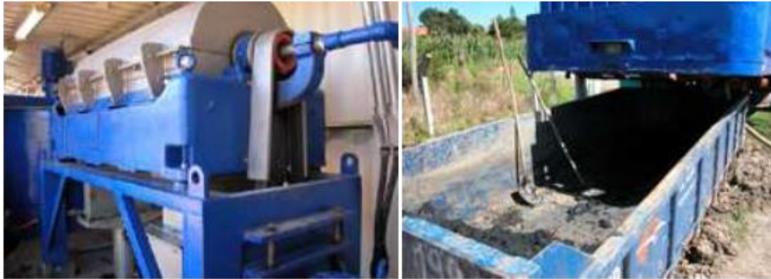
Figura 12 – Centrífuga para secagem e caçamba de coleta de resíduos Fonte: (18)
