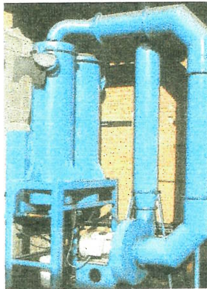
Figura 3.8 – Sistema de exaustão
