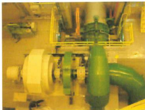
Figura 3.17. PCH Fumaça Equipada com Turbina Francis.
