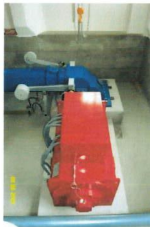
Figura 3.29. Usina Equipada com Turbina Cross-Flow.
