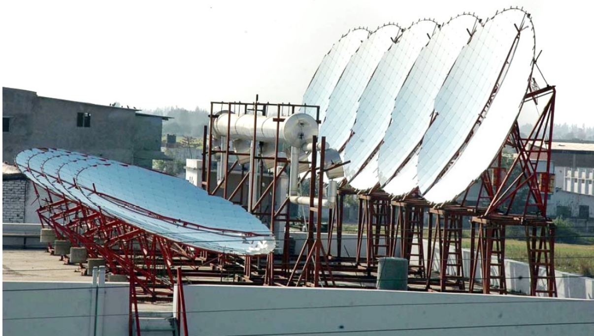
Figura 2.18 – Sistema de aquecimento com dez concentradores Scheffler. Lukhi (2009).
