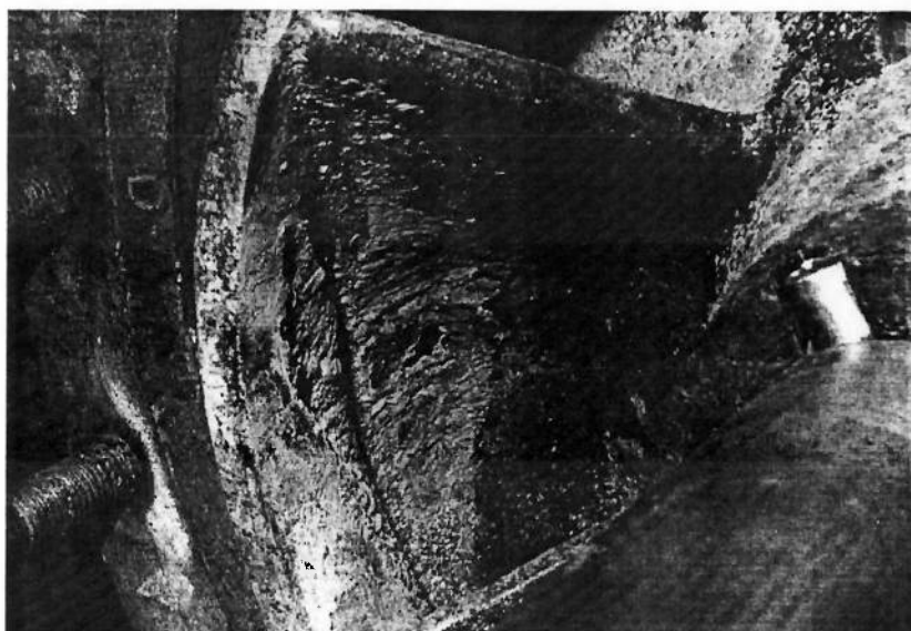
Figura 3.10 - Rotor de bomba centrífuga que trabalhava com água mostrando sinais de dano por cavitação.
