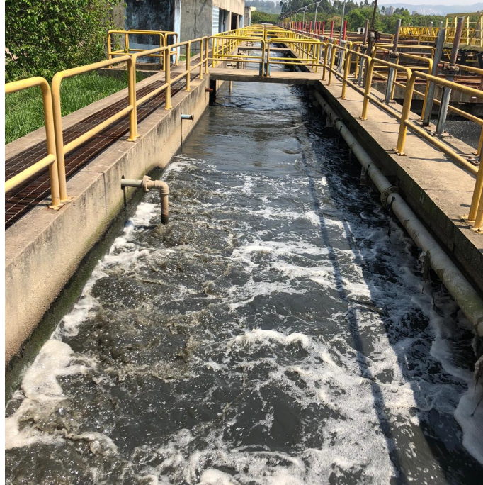
Figura 24 – Canal que alimenta os Decantadores Primários de um módulo.
