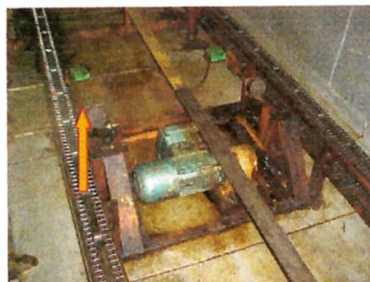
Figura 6.5 Instalação em paralelo de sensor no stop mecânico.
