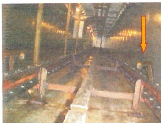
Figura 6.4 – Instalação em paralelo de sensor na linha de entrada da estufa.
