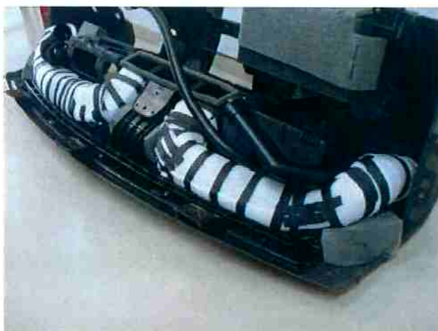
Figura 6.1 Dutos isolados por uma manta térmica.
