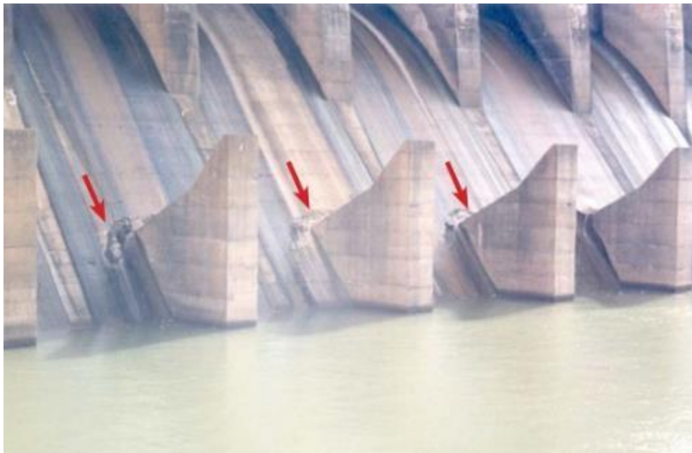
Foto 2.5 – Erosão por cavitação nos blocos dissipadores do vertedouro da Usina Hidrelétrica Ilha Solteira. Fonte: ANA (2016)
