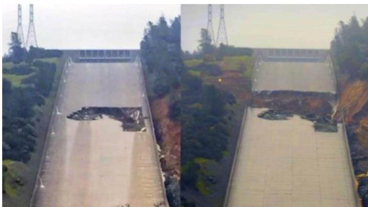
Foto 2.1 - Vertedor da Barragem de Oroville (EUA) com sérios danos em sua estrutura. Fonte: https://www.gh Engenharia.com.br .
