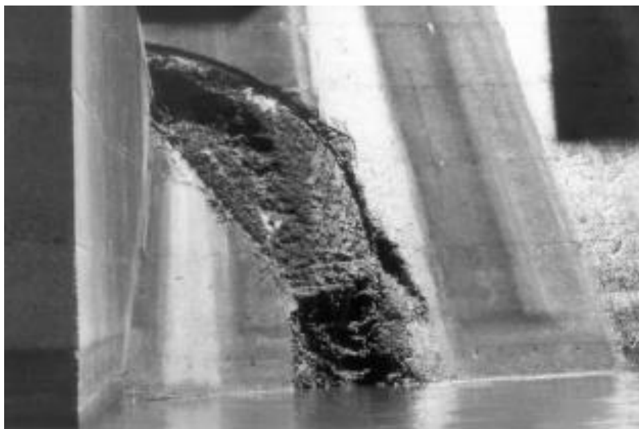
Foto 2.6 – Erosão por cavitação nos blocos dissipadores do vertedouro da Usina Hidrelétrica Ilha Solteira. Fonte: Kanashiro et al. (2003).
