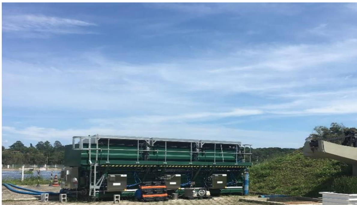
Figura 6 – MABR piloto em operação na SABESP (Arujá-SP)
