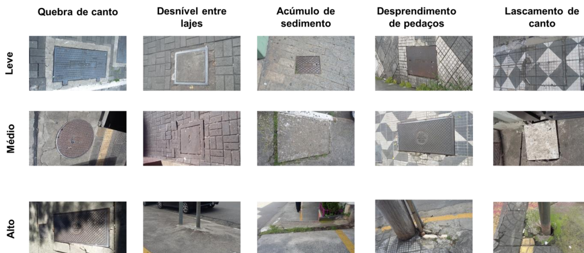
Figura 17 – Exemplos de pavimentos no contorno dos elementos classificados em cada nível da escala de avaliação da conservação superficial aparente
