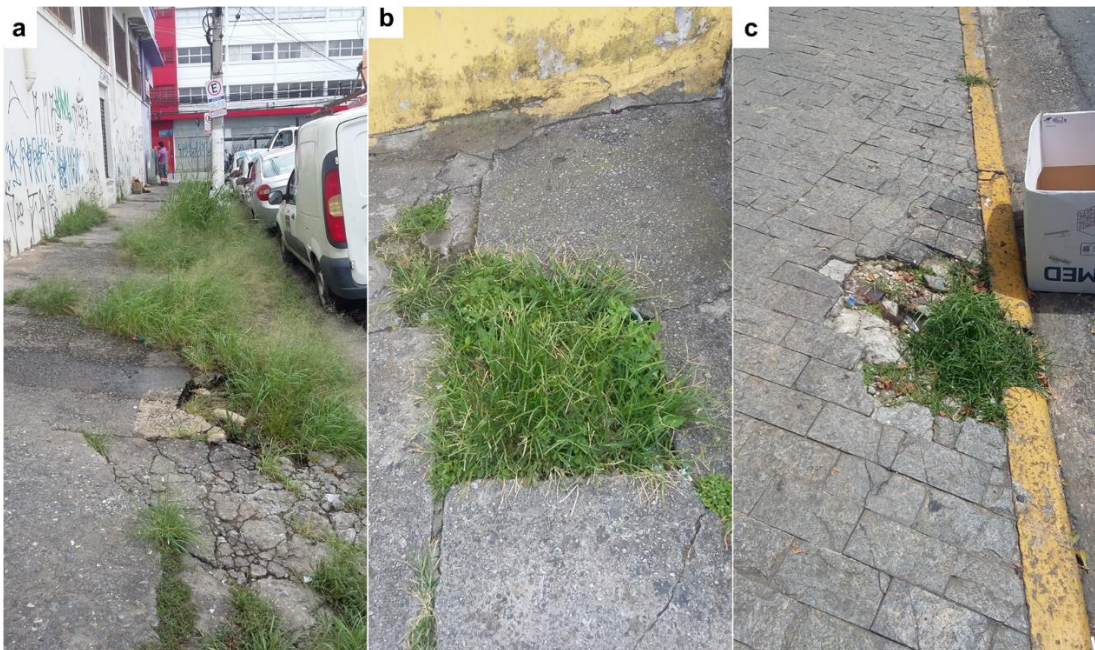
Figura 38 – Exemplos de danos no pavimento das calçadas observados na (a) R. Lancioto Viviane, Osasco, na (b) R. Cel. Domingos Ortiz, em Franco da Rocha, e na (c) R. Fernando de Albuquerque, em São Paulo
