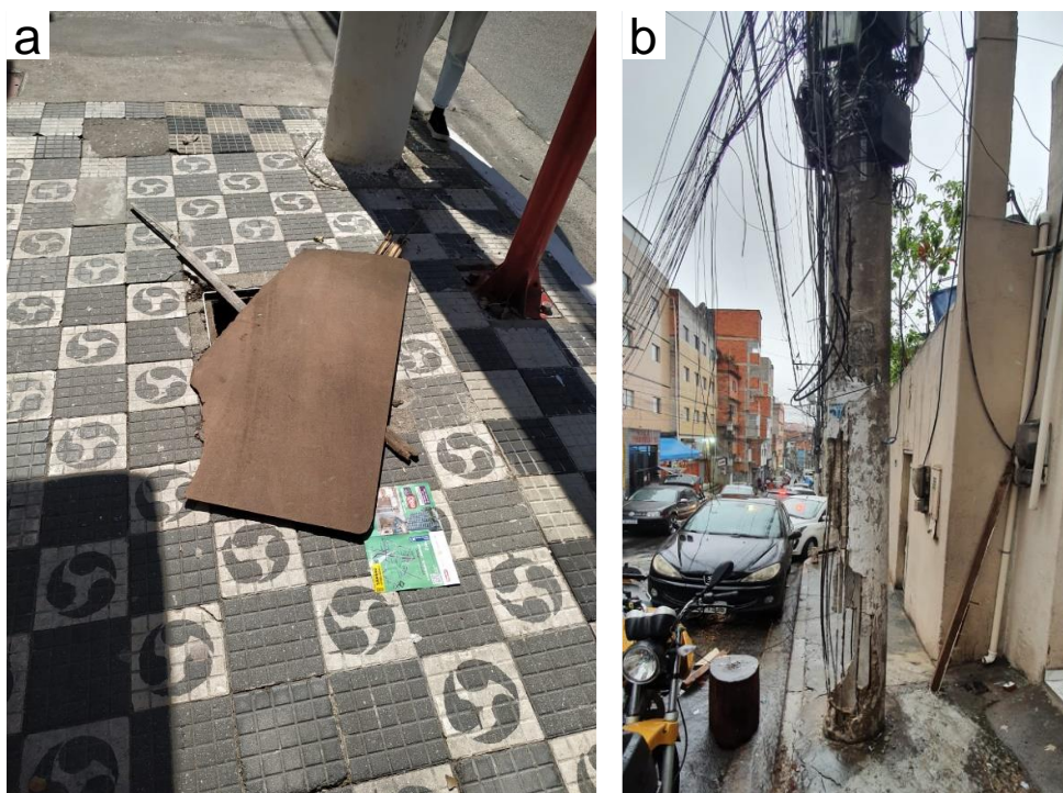
Figura 5 - Exemplos de elementos da rede em mal estado de conservação. (a) caixa de acesso à rede subterrâneo posicionada na faixa livre e sem tampa e (b) poste com viação elétrica solta e estrutura em estado de degradação grave
