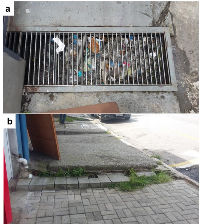
Figura 39 – Exemplos de ramais de ligação irregulares (a) grelha com acúmulo de sedimento e (b) pavimento de recobrimento da tubulação quebrado
