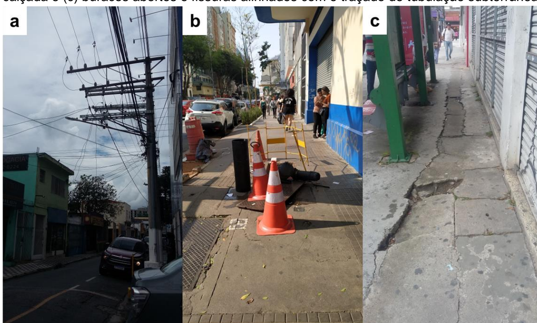
Figura 2 - Exemplos do desarranjo das redes de infraestrutura. (a) poluição visual dos cabeadamentos aéreos, (b) operação de manutenção em uma caixa subterrânea com obstrução parcial em uma calçada e (c) buracos abertos e fissuras alinhados com o traçado de tubulação subterrânea
