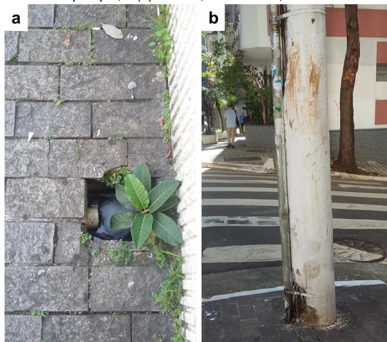
Figura 45 – Exemplo de elementos com danos graves pertencentes às redes de (a) drenagem, na R. Fernando Albuquerque, e (b) elétrica, na R. Costa, ambas em São Paulo
