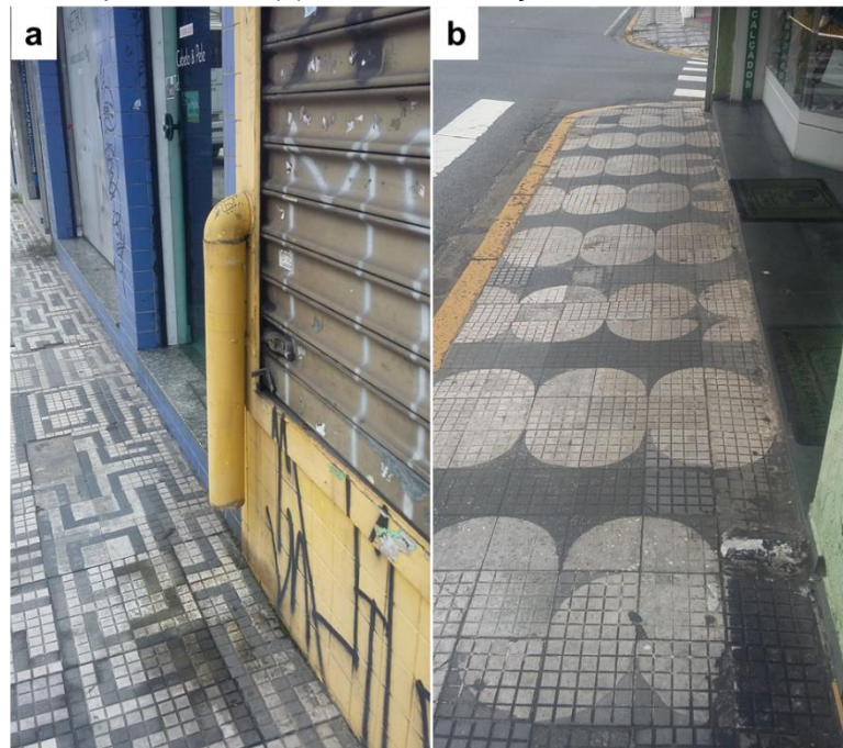
Figura 40 – Exemplos de ramais de ligação irregulares (a) tubulação finalizando acima do nível do pavimento e (b) curva da tubulação sobressaltada
