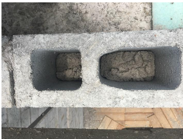
Figura 12: Perdas incorporadas devido à argamassa introduzida acidentalmente nos orifícios dos blocos sem função estrutural. Fotos tiradas pela autora durante coleta de dados na obra.
