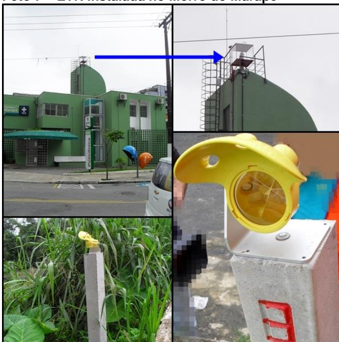
Foto 7 – ETR instalada no Morro do Marapé
