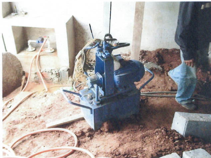
Foto 5.2.2 – Bomba hidráulica, detalhe do manômetro na parte superior.
