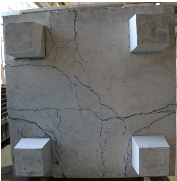
Figura 7.15 - Padrão de fissuração do fundo do bloco após o ensaio para o bloco N1B45A1D
