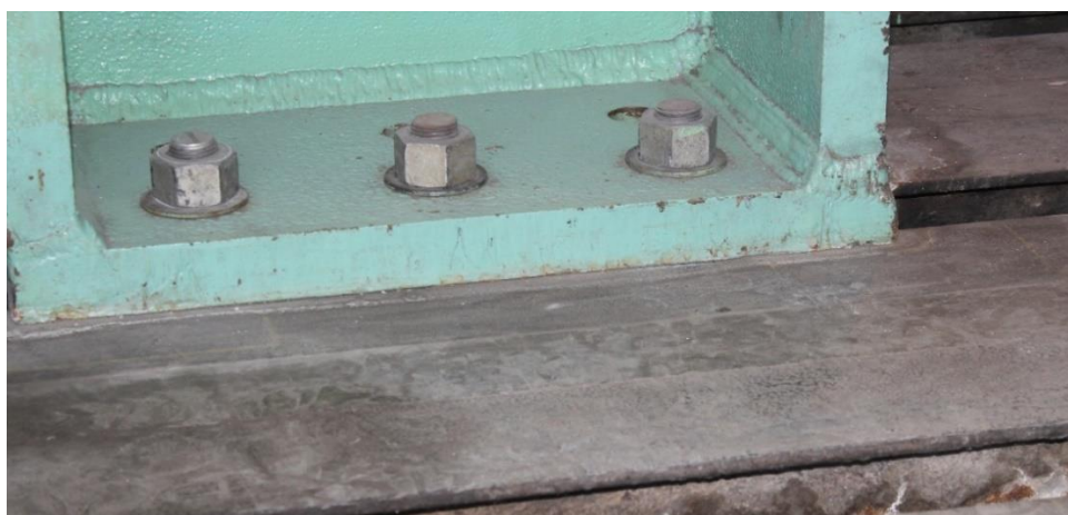
Figura 6.2 - Ligação do pórtico na laje de reação por meio de barras rosqueadas
