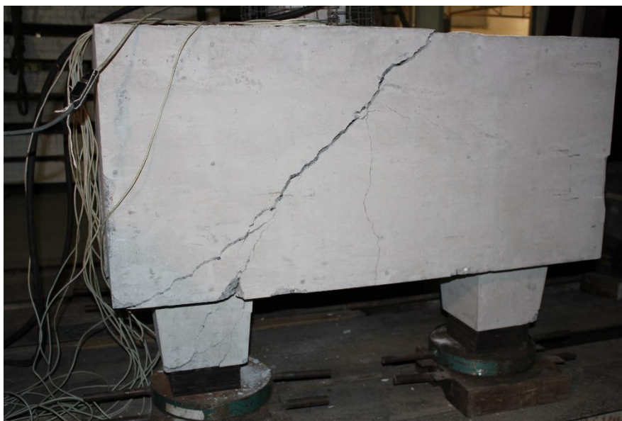
Figura 7.3 - Aspecto das fissuras em uma face do bloco N1B45A2C após o ensaio
