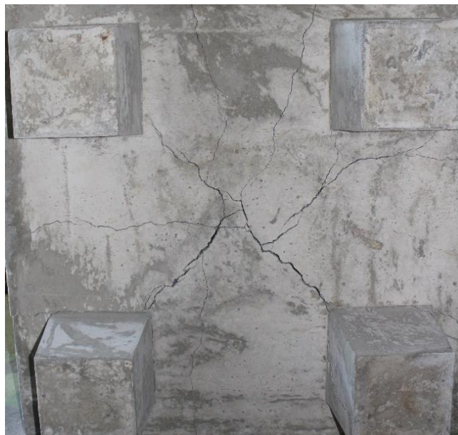
Figura 7.39 - Fissuração no fundo do bloco N2B45A1C
