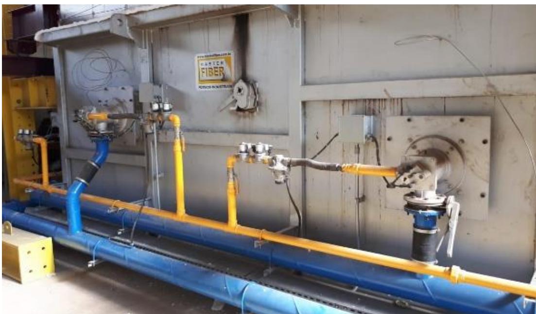
Figura 3.13 – Válvulas do forno
