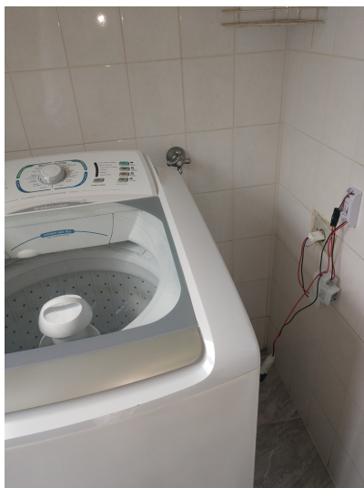
Figura 16 – Instalação do medidor de energia na carga Máquina de Lavar
