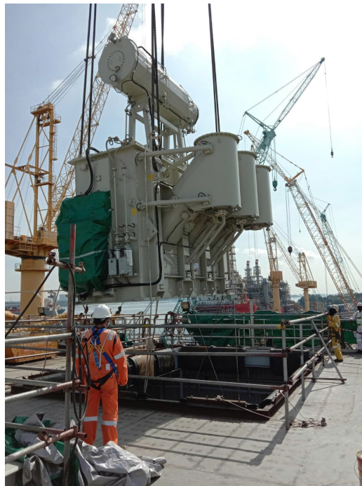
Figura 1.6 – Transformador trifásico para aplicação HVDC instalado em plataforma marítima Fonte: HITACHI ENERGY.
