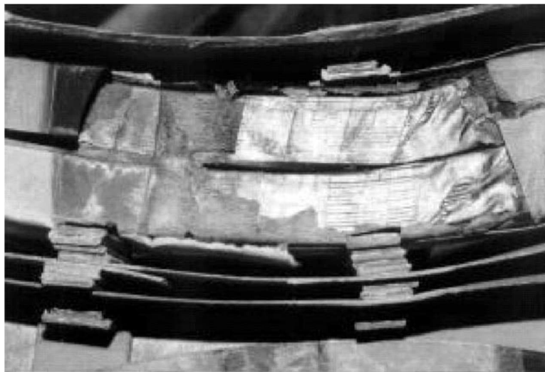
Figura 3.7 – Isolamento do enrolamento de válvula em delta danificado devido ao sobreaquecimento
