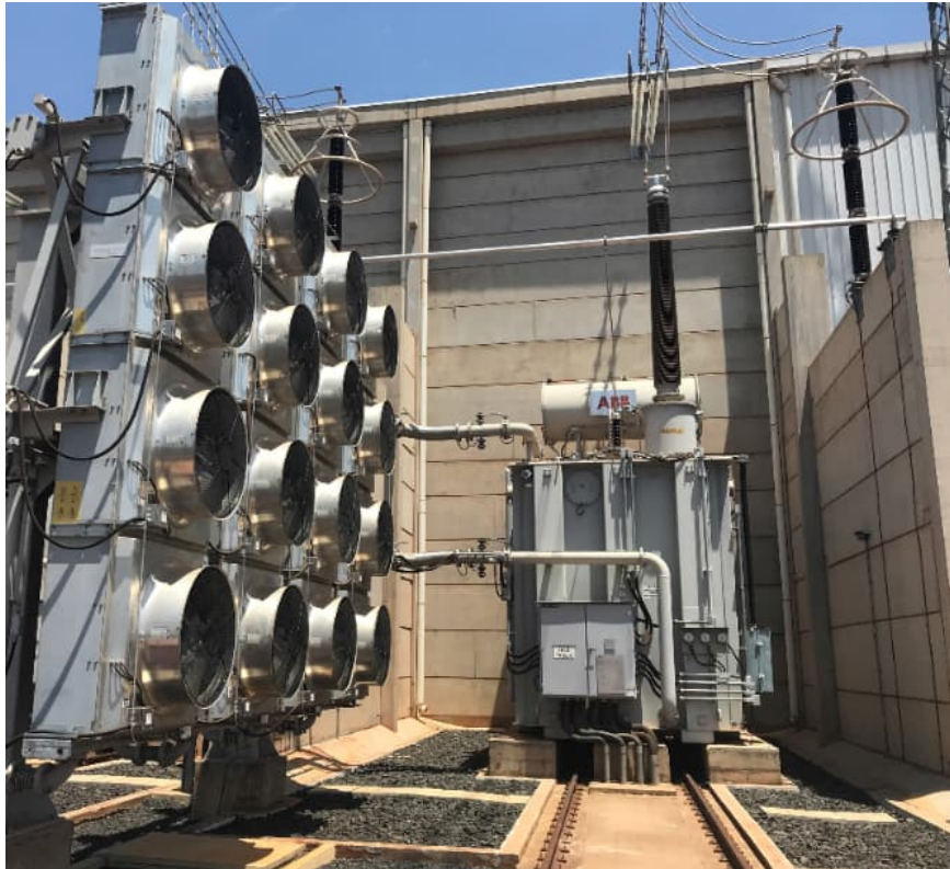
Figura 3.8 – Banco de trocadores de calor óleo-ar instalados separados do tanque do transformador conversor
