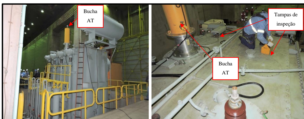
Figura 5.11 Vista geral externa do transformador com indicação da bucha de alta tensão e vista superior do transformador com indicação da bucha de alta tensão e tampas de inspeção (RBENGE, 2020)
