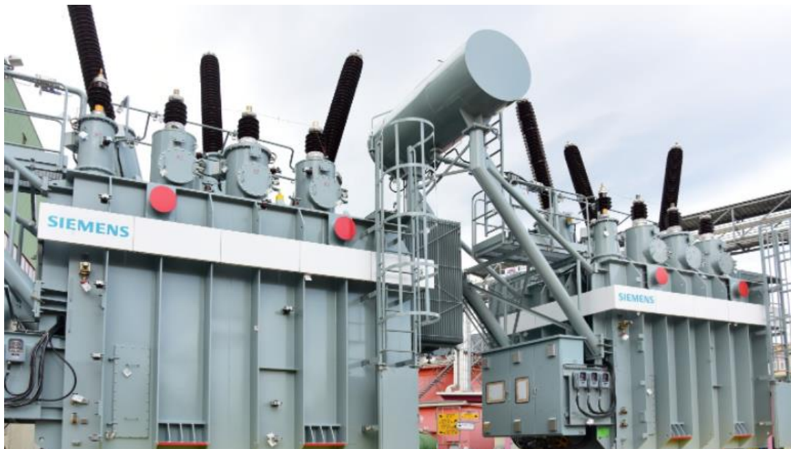
Figura 2.5 Transformador elevador (SIEMENS, 2021)
