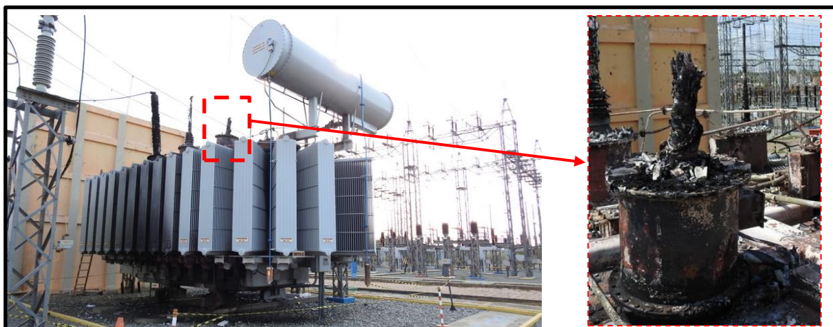
Figura 6.2 (a) Estilhaçamento de porcelana, carbonização e consumo do corpo condensivo de bucha de alta tensão de transformador trifásico de 100 MVA, 230 kV. (b) detalhamento dos danos (AUTOR)
