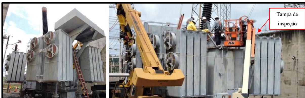
Figura 5.20 Vista geral do transformador e pessoal se preparando para ingresso no tanque (RBENGE, 2016)
