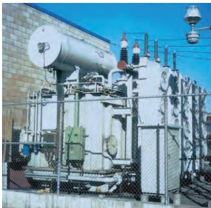
Figura 2.6 Transformador retificador (GE XD, 2014)
