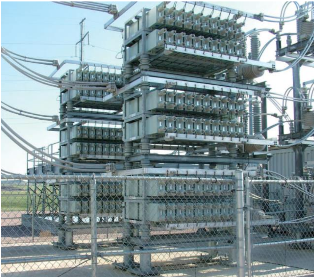
Figura 4 – Exemplo de banco de capacitores em derivação
