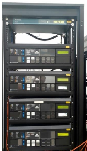
Figura 38 - Painel de Proteção GE.
