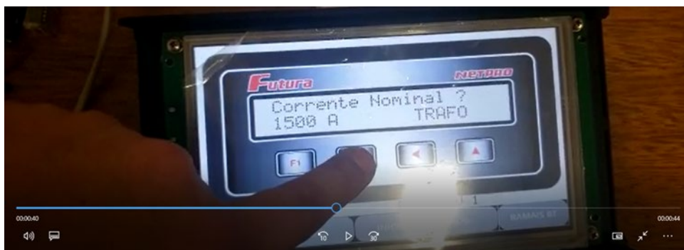
Figura 56 – Tela do C-GD (placa V80H + display 7”) emulando tela do relé de proteção do equipamento Protetor de Redes: tela de entrada de ajustes de SETUP do relé – indicação da corrente nominal do transformador do Spot.
