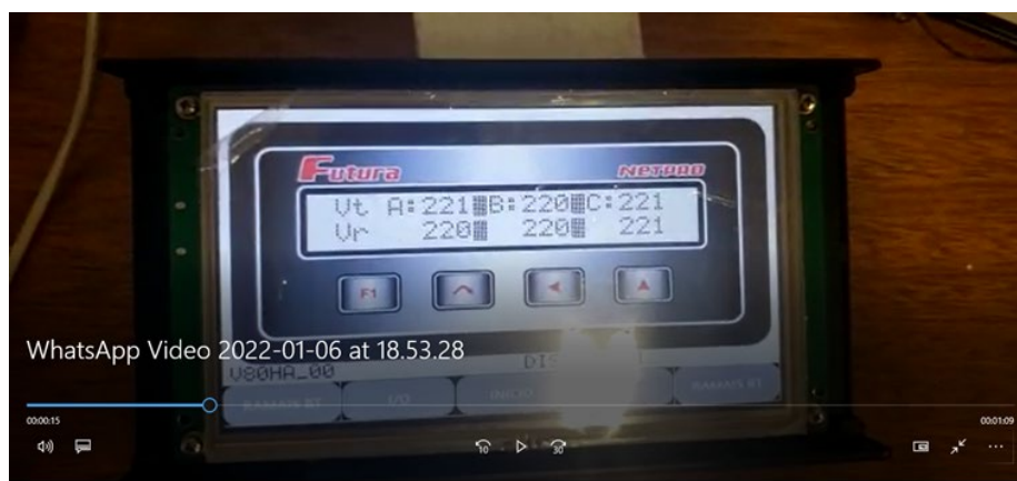
Figura 53 – Tela do C-GD (placa V80H + display 7”) emulando tela do relé de proteção do equipamento Protetor de Redes: tela de tensões de transformador e de rede (protetor de redes aberto).
