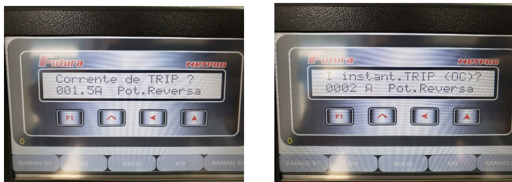
Figura 76 – Ajustes de corrente reversa temporizada (-1,5 A) e instantânea (-2 A) para os testes com transitórios de carga e GD.
