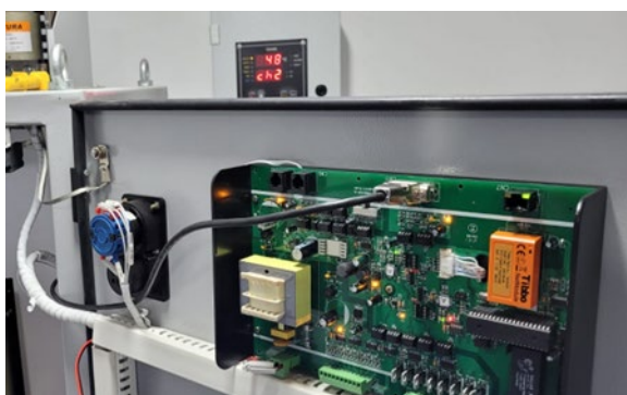
Figura 68 – Controlador de GD (C-GD) instalado no local do IHM do protetor de redes, conectado ao relé de proteção por comunicação serial RS232
