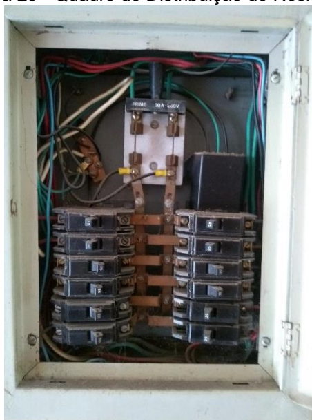
Figura 29 - Quadro de Distribuição de Residência
