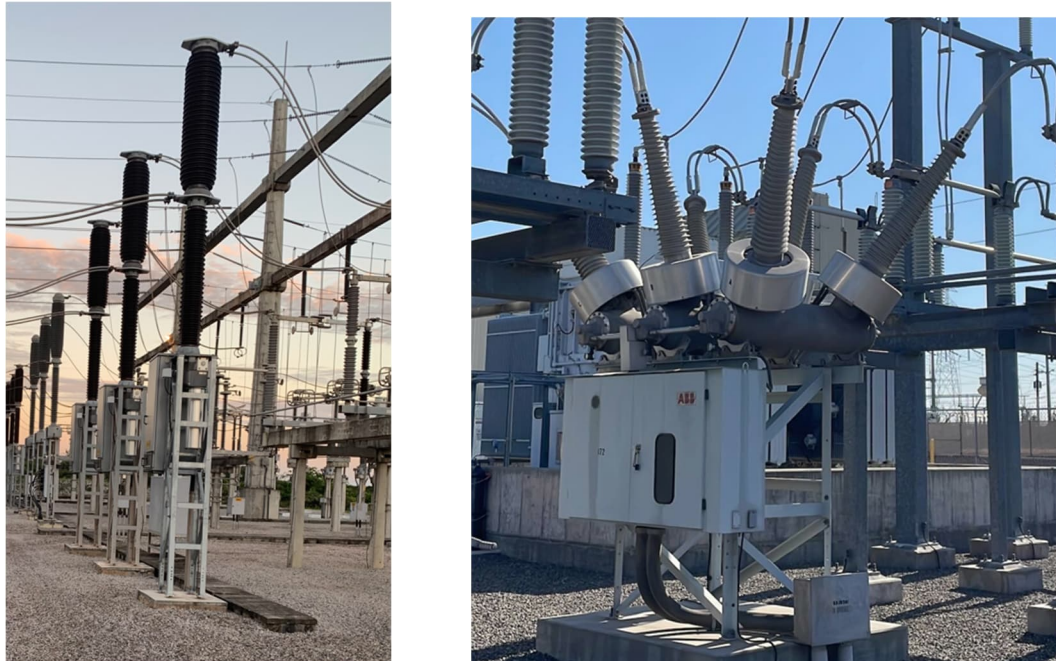
Figura 6- Esquerda disjuntor a SF 6 de tanque vivo - Direita disjuntor a SF 6 de tanque morto - Do autor
