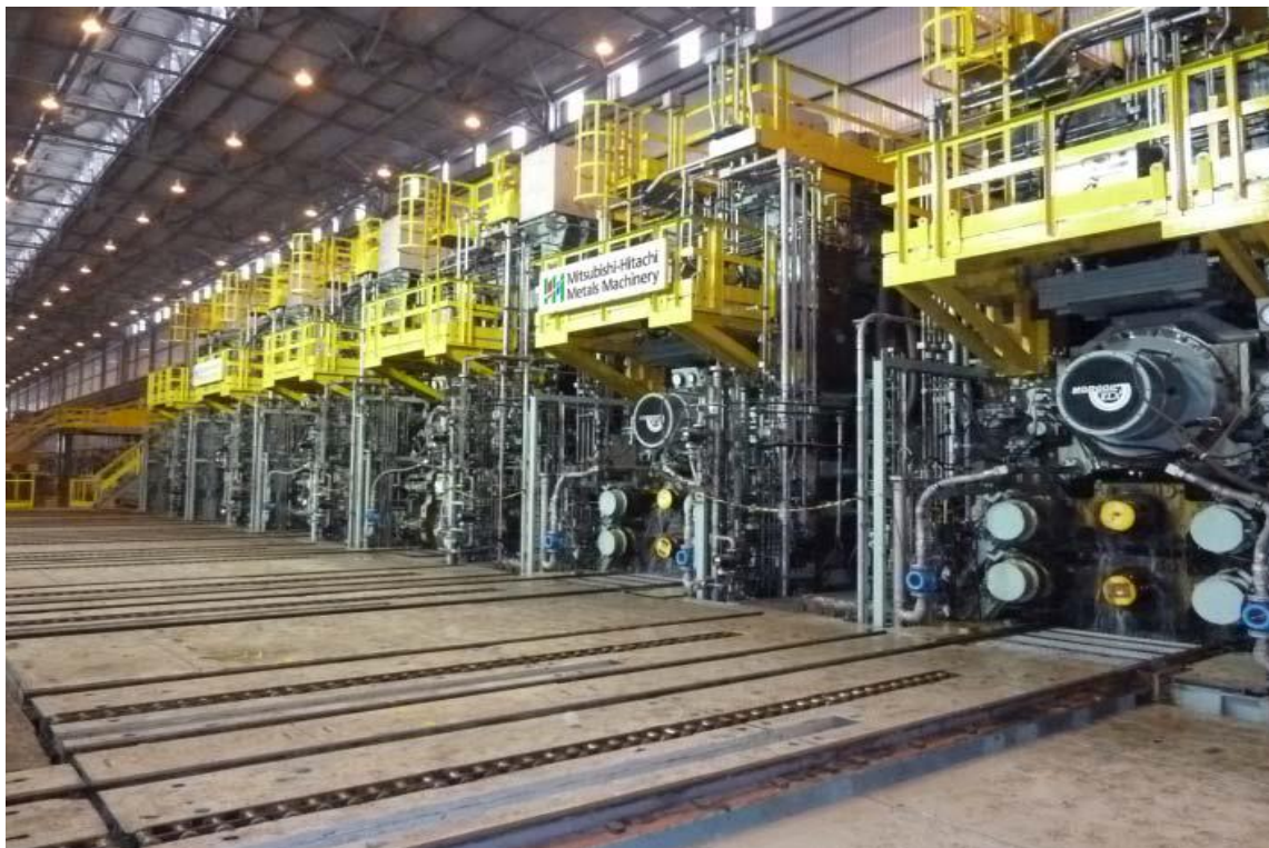
Figura 22 – Fotografia do trem acabador no tiras a quente.
