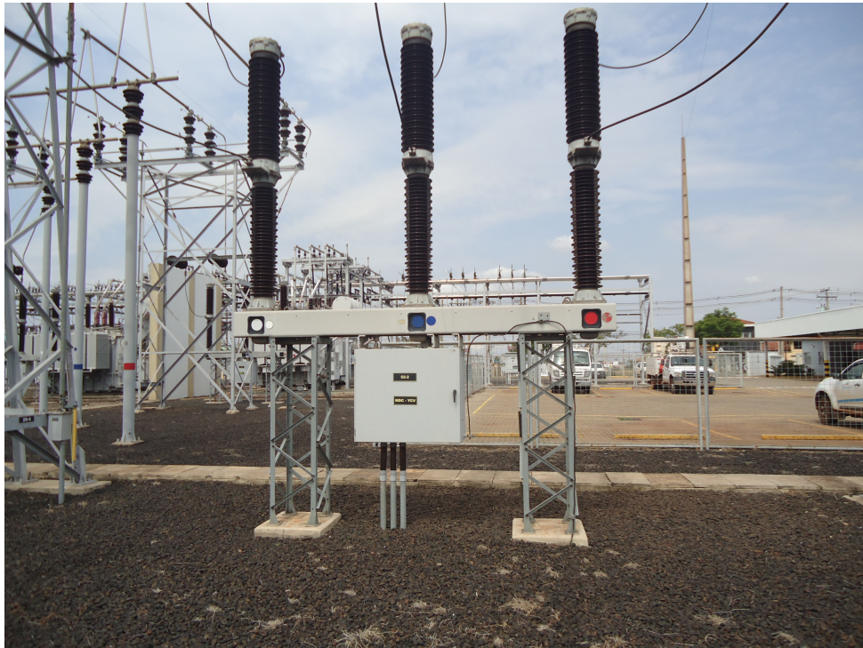
Figura 2: Exemplo - Disjuntor tipo tanque-vivo
