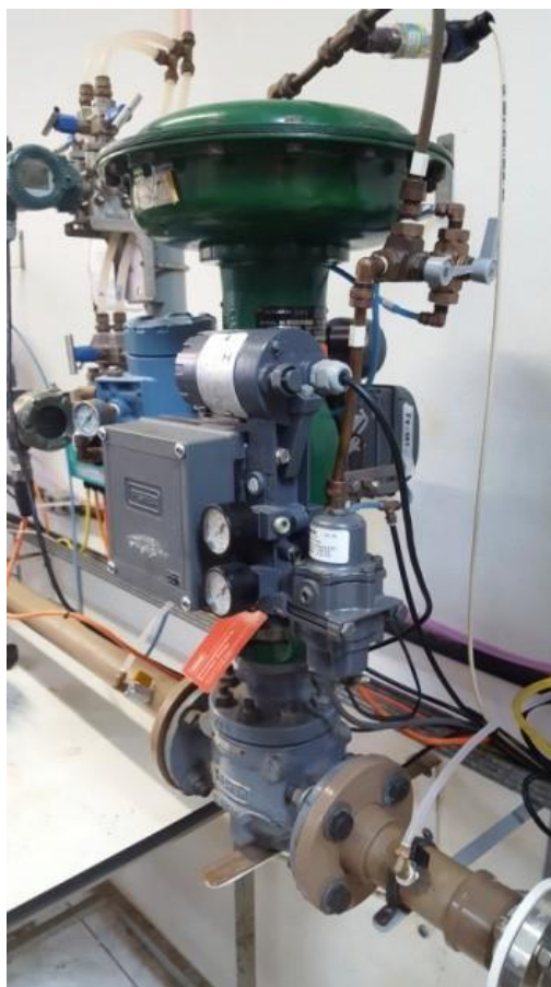
Fig. 2.3 - Conjunto da válvula FV-11 e instrumentação associada – LCPI. Fonte: Manual de Operação da Planta Piloto de Vazão - LCPI – 2018.
