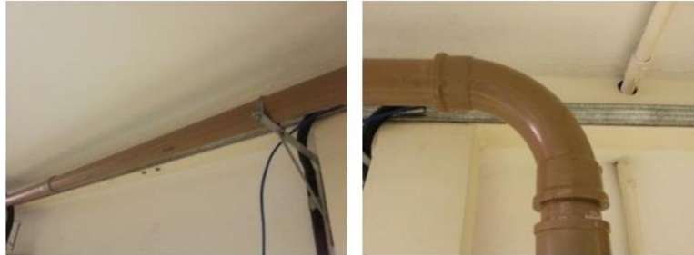
Figura 18 - Tubulação da Planta Piloto de Vazão do LCPI
