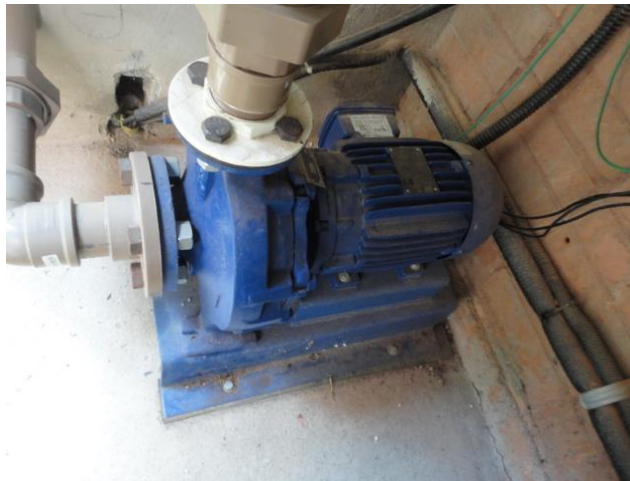
Figura 3 - Conjunto motobomba KSB e WEG
