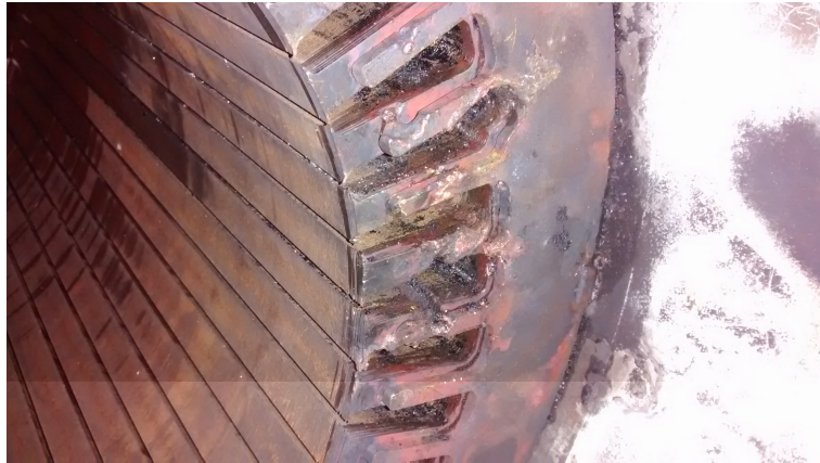
Figura 6: Fusão no núcleo do estator decorrente de curto-circuito.
