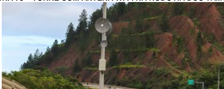
FIGURA 75 – TORRE COM ANTENA WI FI NA RODOVIA DOS TAMOIOS
