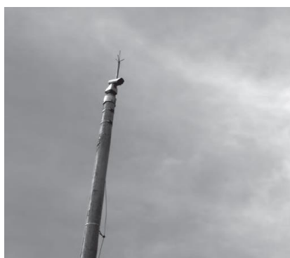
FIGURA 34– POSTE COM CÂMARA CFTV
