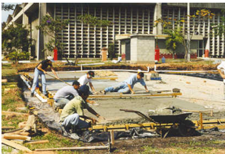
Foto 6.10 Desempenho do concreto da seção A
