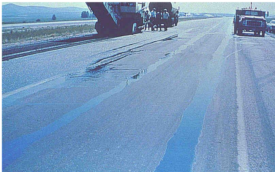
Figura 11 - Afundamento em trilha de roda com acúmulo de água
