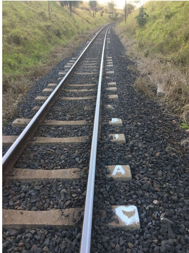
Figura 39 - Sistema de drenagem comprometido no km 357+000 ZOL-ZHB
