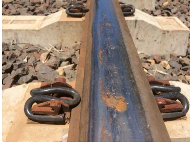
Figura 6 - Defeito superficial pela instabilidade de plataforma
