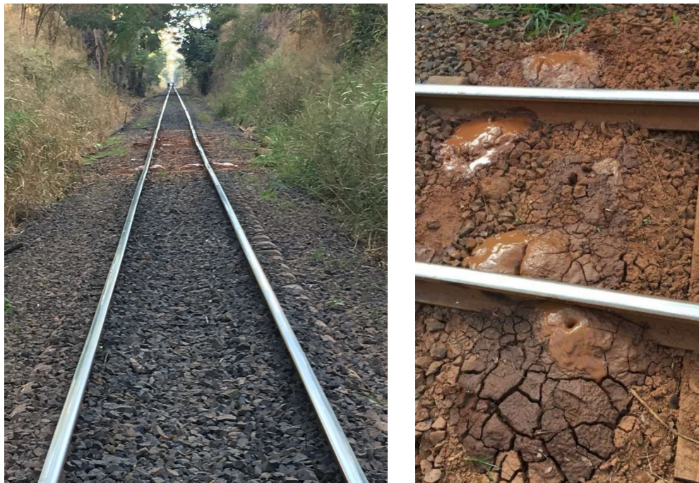
Figura 40 - Desnivelamento de via causado por baixa capacidade de suporte do subleito saturado no km 335+900 ZKR-ZOL
