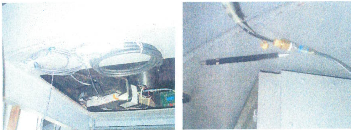
FIGURA 25 - SENSORES DE PRESSÃO
