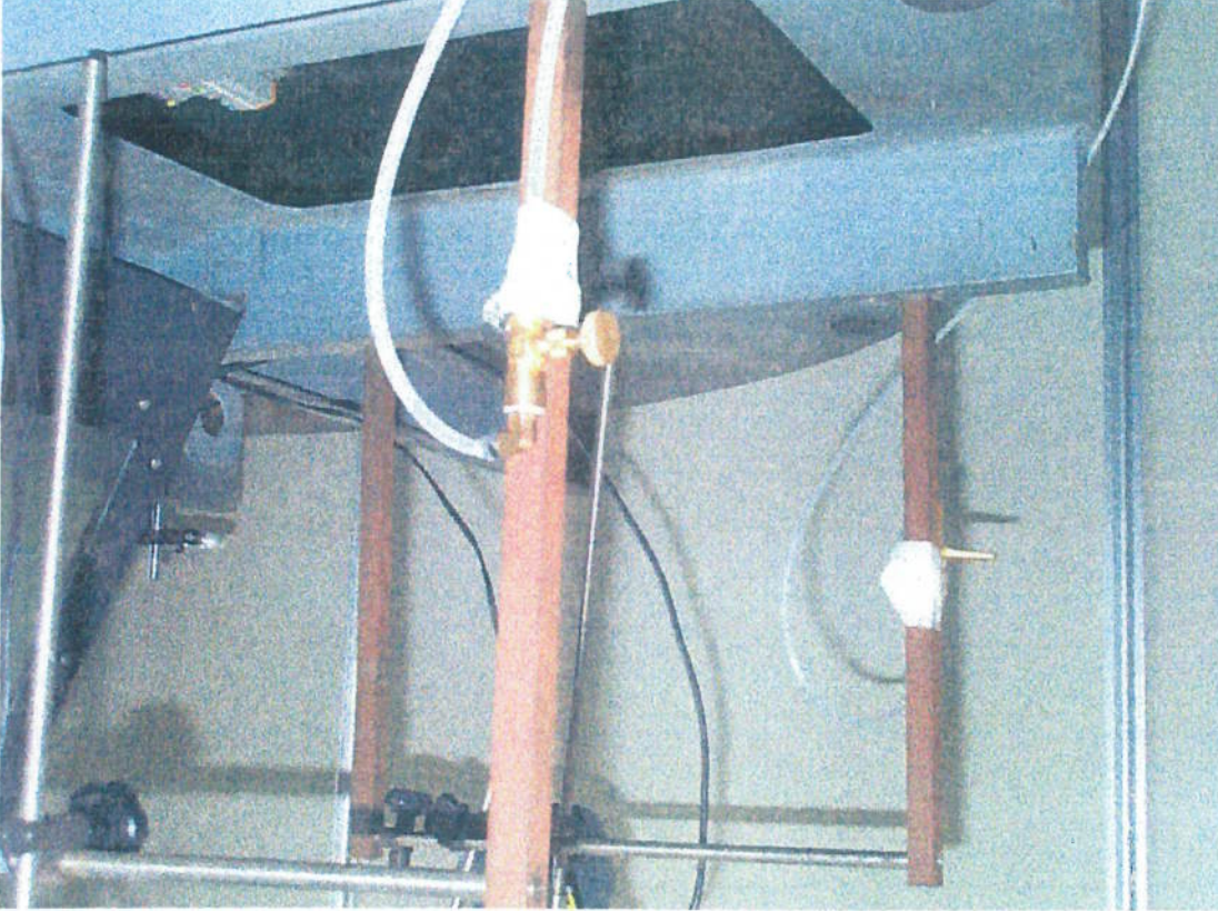
Detalhe de Parte do Sistema de Sucção e Controle de Nível D'água
