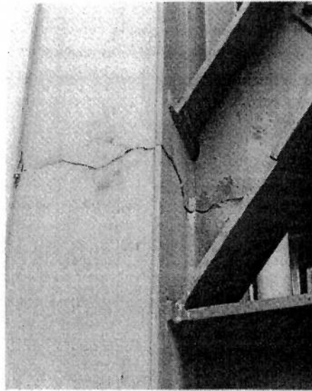
Figura 2 Trinca em estrutura metálica em Kobe (1995), na qual a fratura frágil (clivagem) originou-se a partir de regiões intensamente plastificadas nas juntas soldadas.
