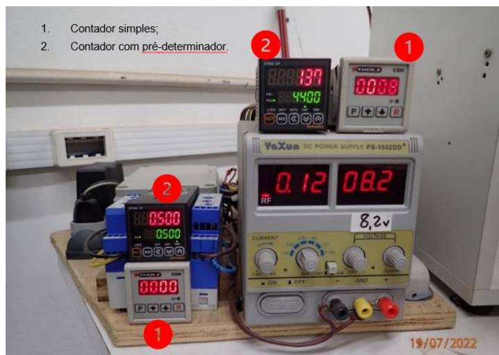
Figura 9 - Vista detalhada do painel de controle
