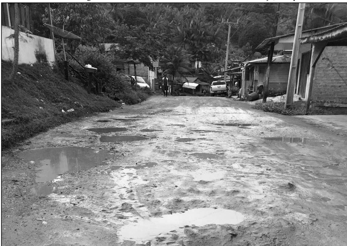
Figura 46 – Falta de infraestrutura no Distrito de Lourenço, Amapá.
