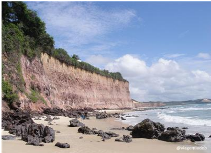
Figura 2: Encosta em solo na Praia de Pipa, RN
