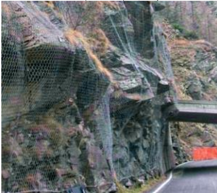
Figura 17: Talude rochoso com blocos passíveis de queda, reforçado com tela de cabos de aço.
