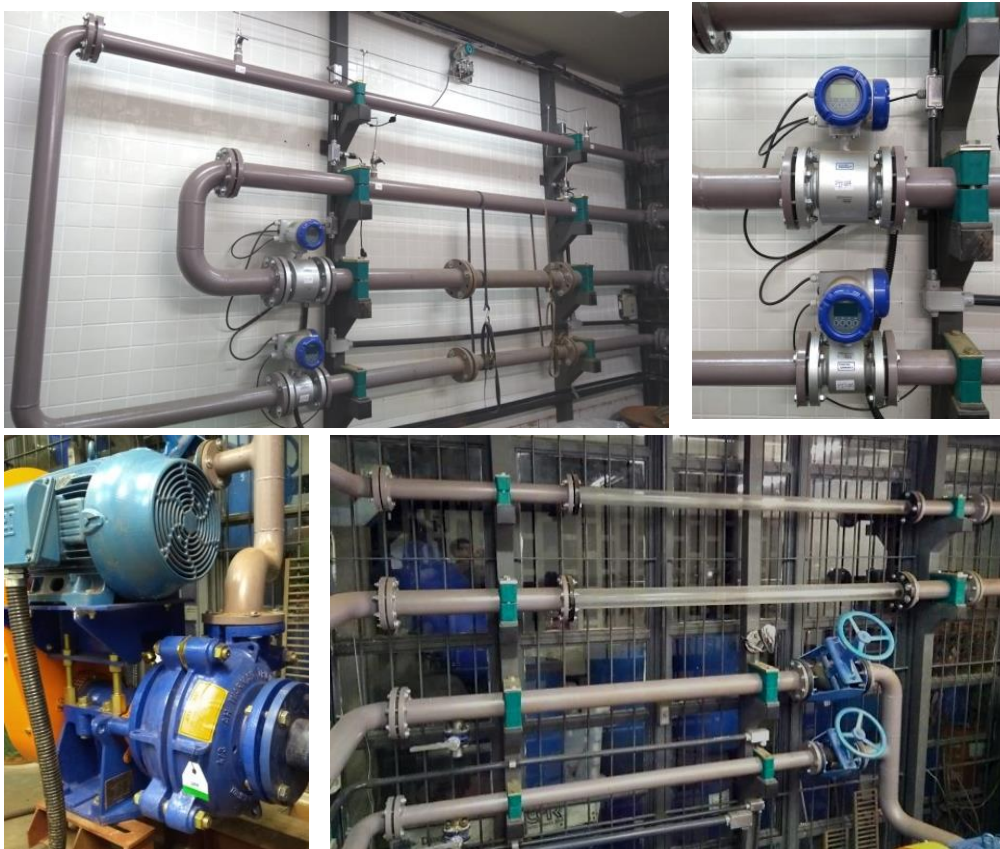
Figura 3.3 – Unidade de bombeamento com dutos de diâmetros 76,2 e 101,6 milímetros.
