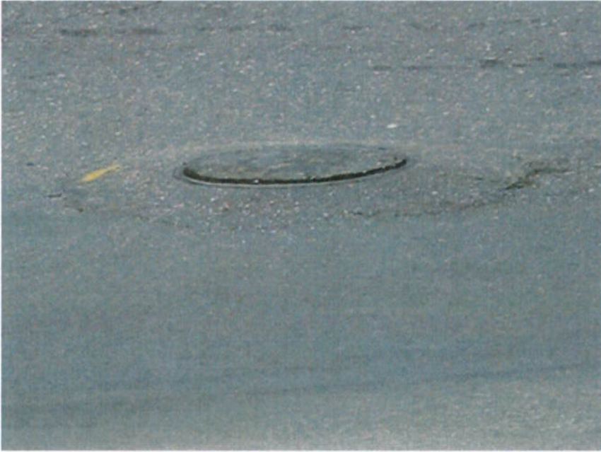
Figura 4.3 – Trechos de Pista com Buracos de Maior Amplitude (Simulação de Entrada de Bateite)
