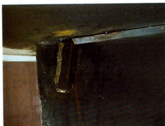
Fig. 6.11 Proteção por resina nas bolsas.
