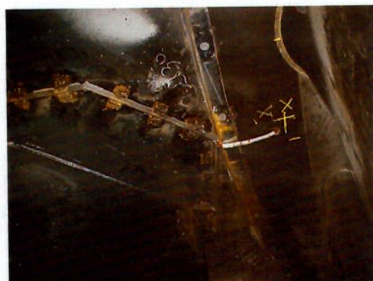
Fig. 6.13 Entrada dos cabos pelo furo inferior da tampa.
