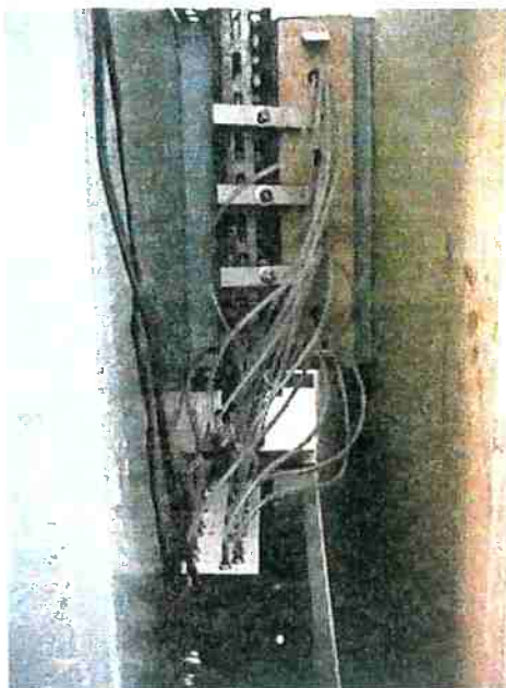
Figura 7.7: Vista da conexão da grade sensora com o sistema monitor de pressão
