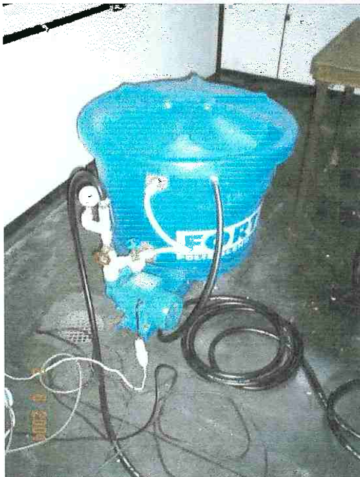
Fig. 4.8 – Sistema de circulação de água para refrigeração do instrumento
