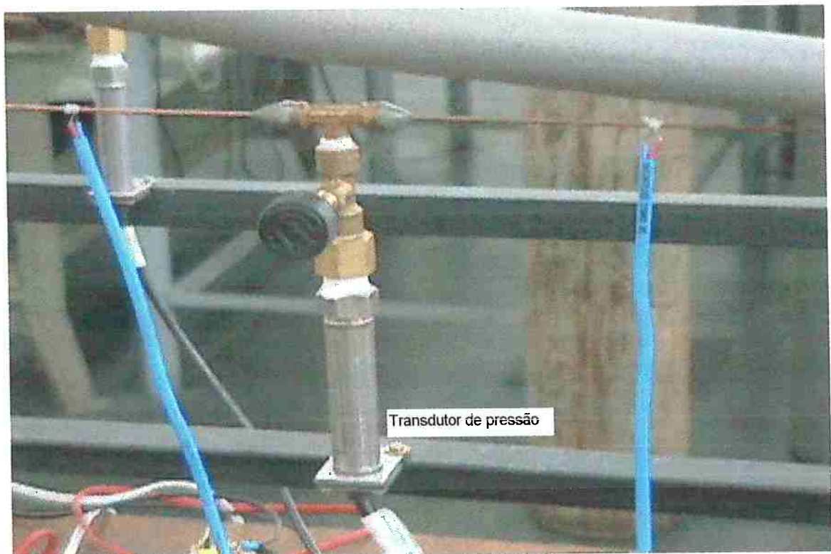
Figura 6.19 Detalhe da instalação dos transdutores de pressão e dos termopares na seção de testes.
