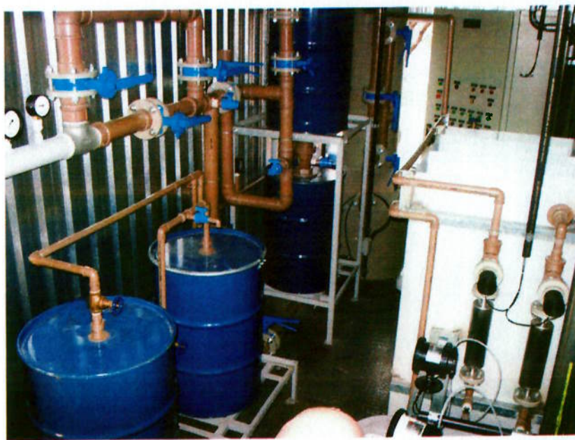
Figura 5.11. Foto do Sistema de Extração Multifásica Instalado
