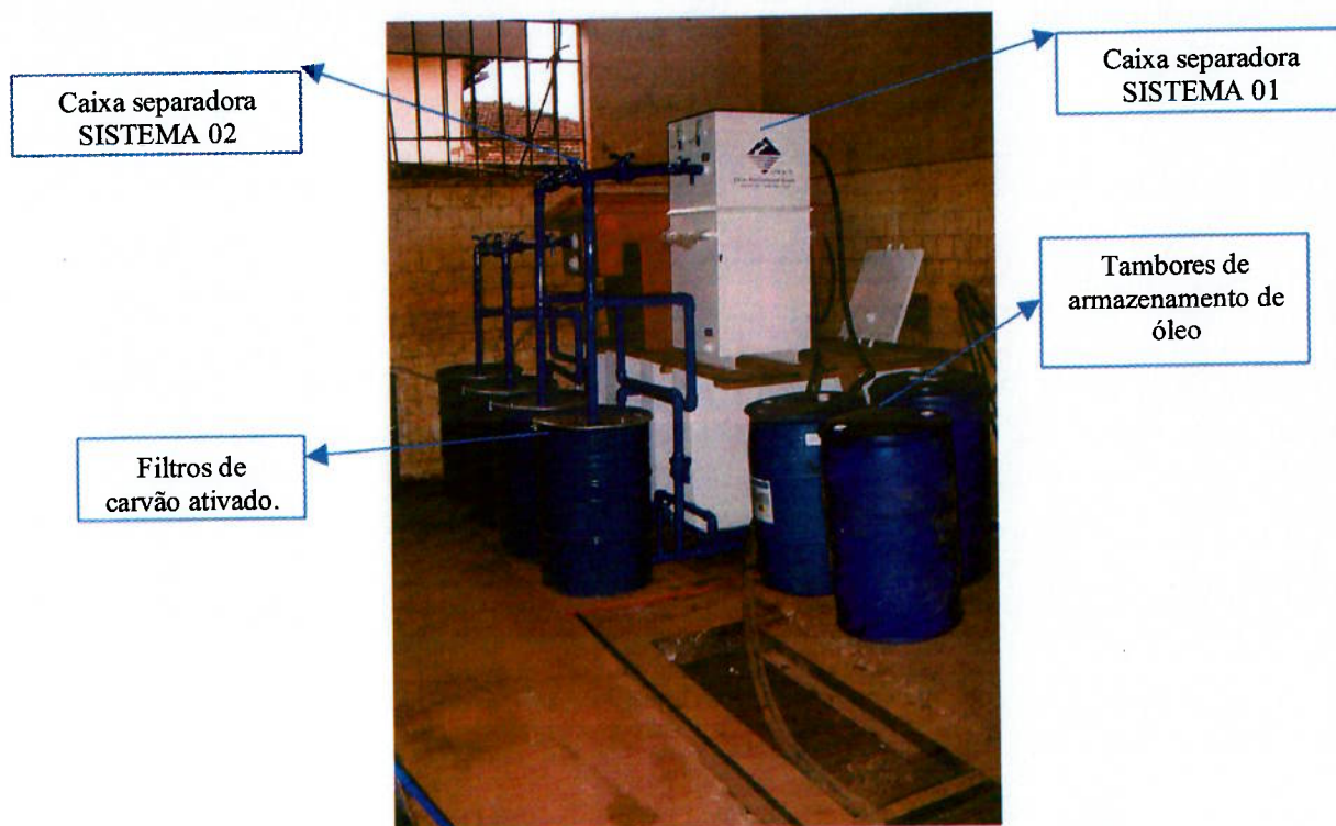
Figura 5.8. – Foto do Sistema de Tratamento Implantado
