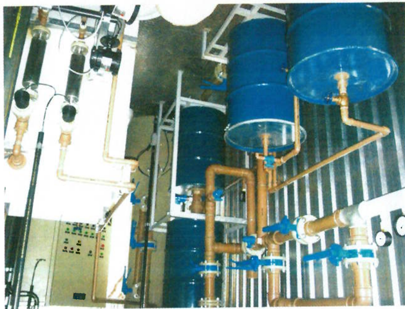
Figura 5.11. Foto do Sistema de Extração Multifásica Instalado
