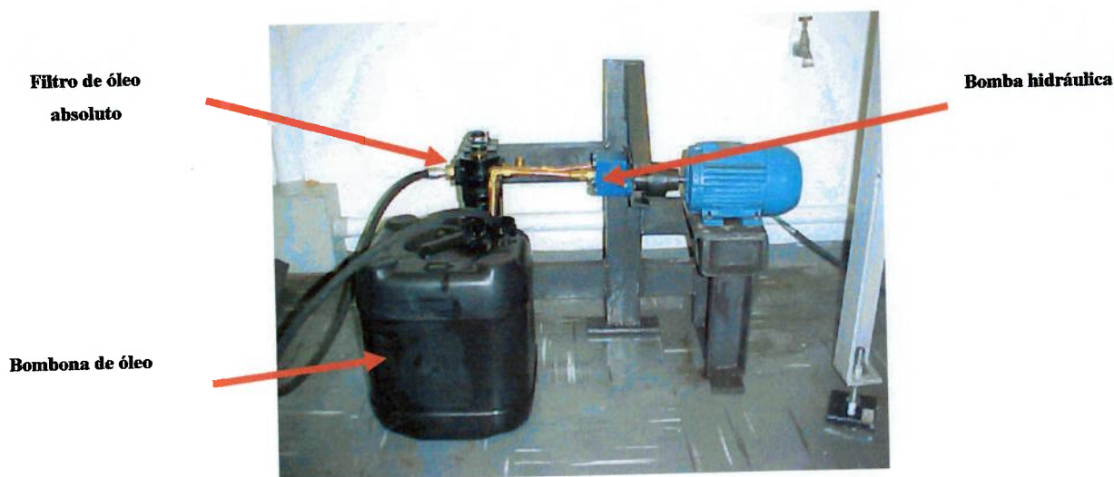
Figura 6-10 Sistema de filtração do óleo lubrificante
